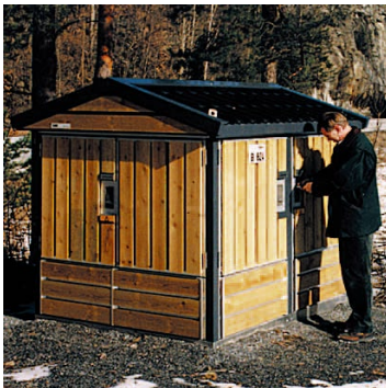
紧凑型二次变电站
