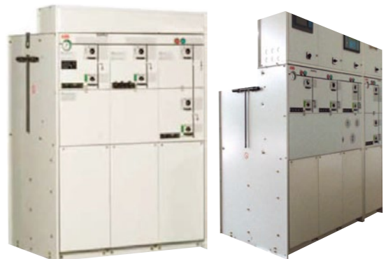
开关柜顶部的二次线小室
