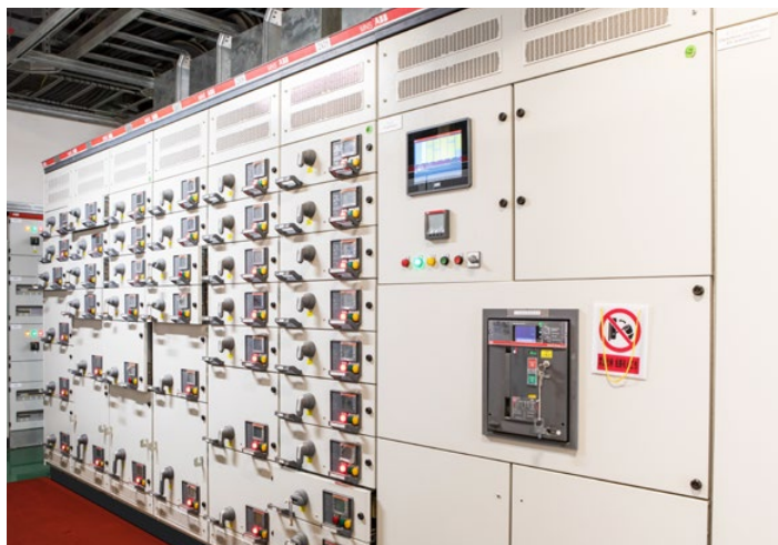
ABB厦门工业中心MNS Digital低压开关柜
